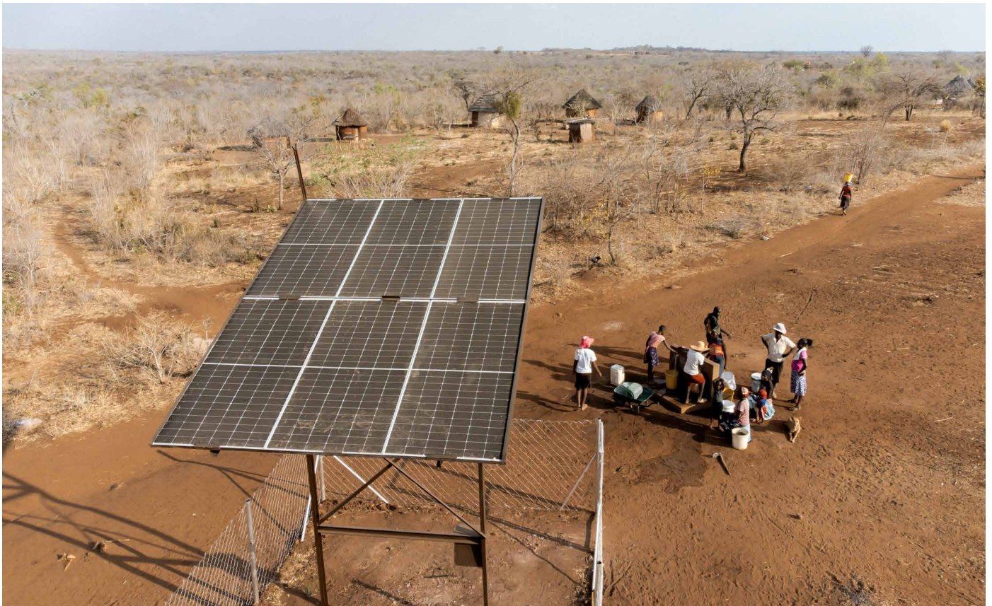
Moderne Technik Eine solarbetriebene Pumpe befördert in Mbizwo seit Kurzem Wasser aus über 100 Meter Tiefe an die Oberfläche.
