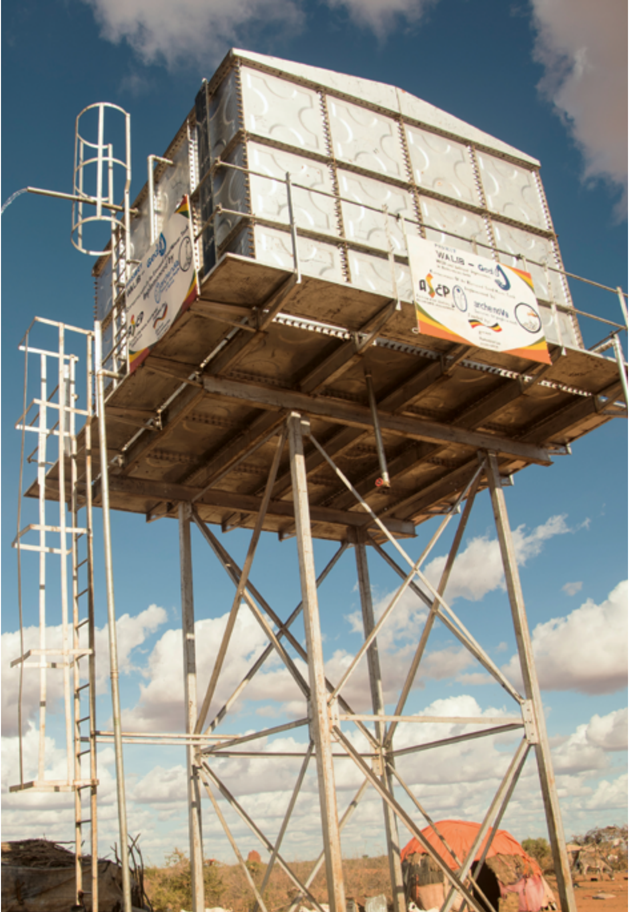
In diesem robusten Wasserhochbehälter wird Wasser zwischengespeichert. Von dort fließt es mit gleichmäßigem Druck an die Wasserabgabestellen.
