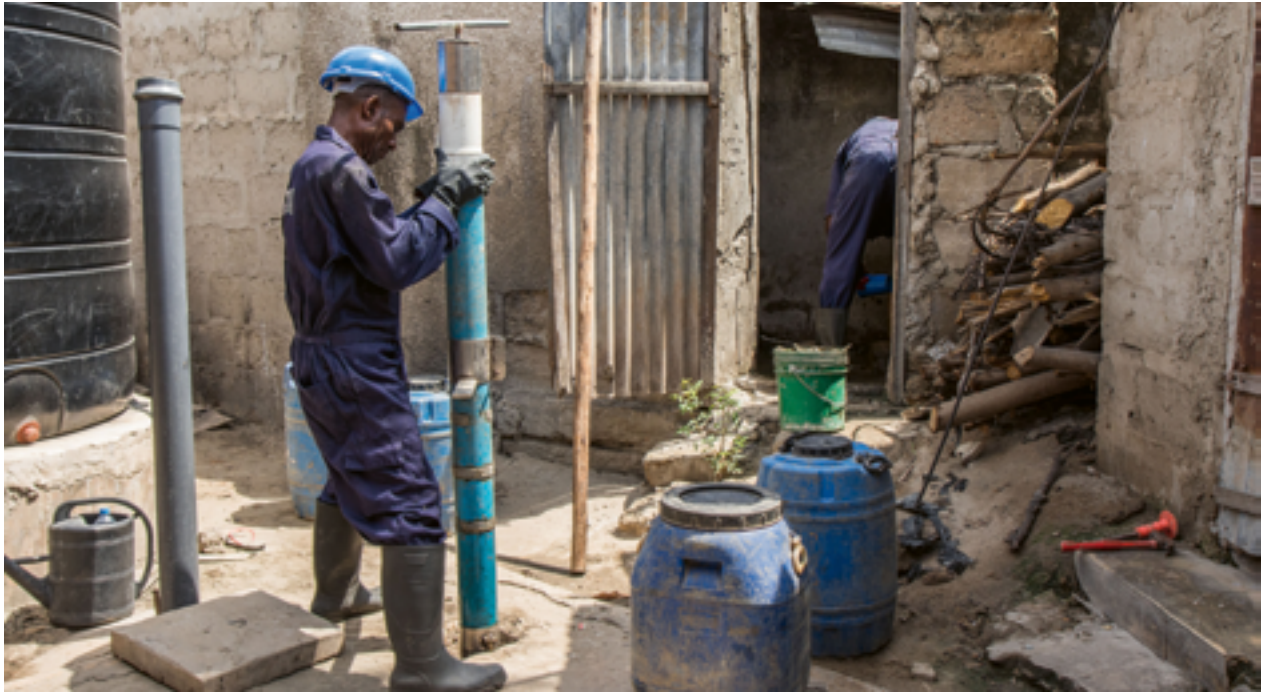
Faultankentleerung im Gebiet Mlalakua, Dar e Salaam, Tansania
