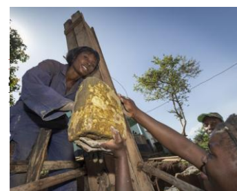
Gemeinsam Frauen auf der Baustelle – das ist in Bukavu nichts Ungewöhnliches. Die meisten von ihnen haben ihre Ausbildung im CAPA gemacht.
