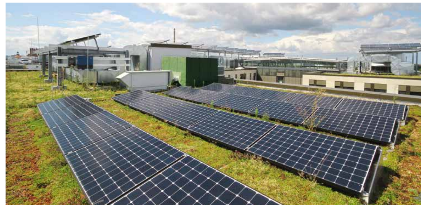
Auf dem Dach der Berliner Zentrale von Brot für die Welt ist eine Photovoltaikanlage installiert. Das Gebäude wurde mehrfach für seine Energieeffizienz ausgezeichnet.
