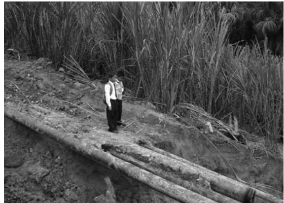
Kinder stehen vor einer zerborstenen Ölpipeline in unmittelbarer Nähe ihres Hauses in Ecuador.
